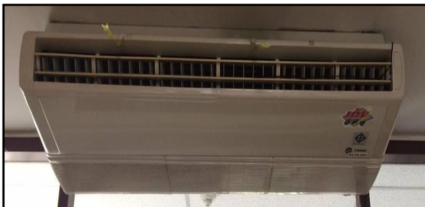
รูปที่ 4.24 (ก) เครื่องปรับอากาศและตัวควบคุมเวลาการทำงาน
