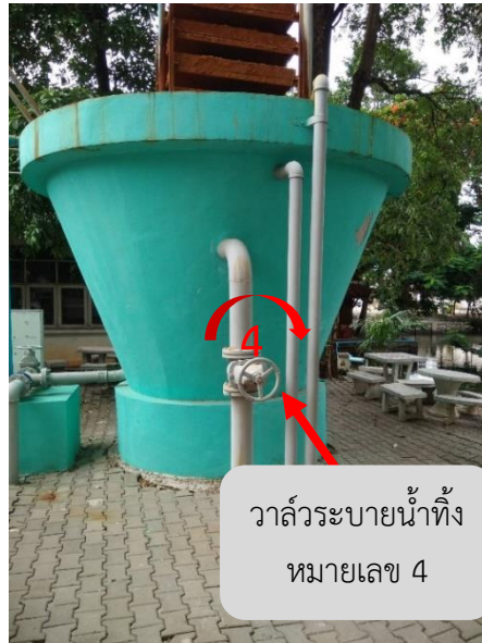
ภาพที่ 4.7 วิธีปิดวาล์วระบายน้ำทิ้ง
