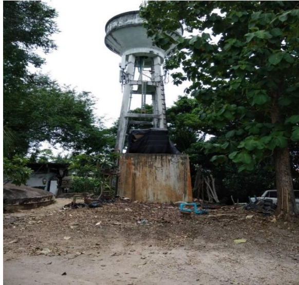
ภาพที่ 4.13 รูปถังกรองน้ำบาดาลบ่อทิศเหนือ ข้างฝ้ายานพาหนะ
