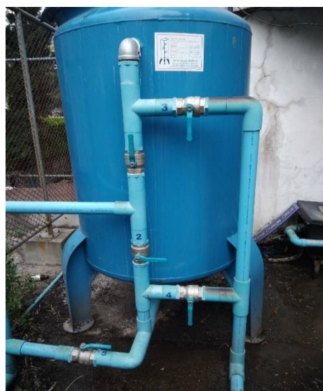
ภาพที่ 4.26 รูปถังกรองน้ำแบบใช้แรงดัน
