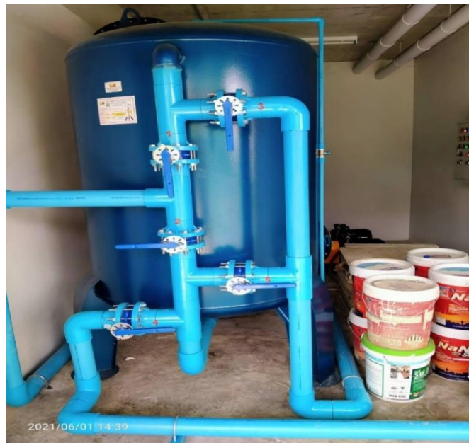
ภาพที่ 4.45 ถังกรองน้ำแบบใช้แรงดัน (Pressure Filter)
