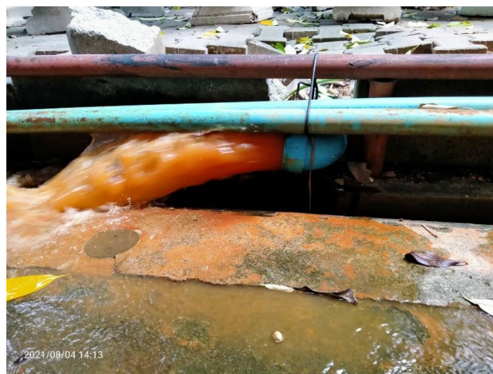
ภาพที่ 4.6 สีน้ำจากท่อระบายน้ำทิ้งขณะทำการล้างสารกรองน้ำ
