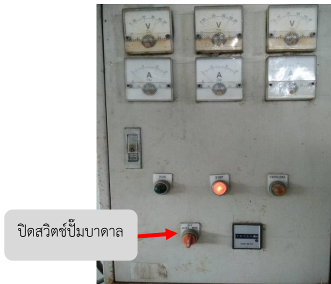
ภาพที่ 4.14 สวิตช์ควบคุมปั๊มบาดาล
