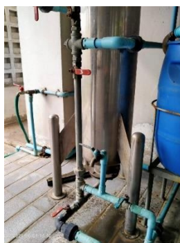
รูปก่อนซ่อม
