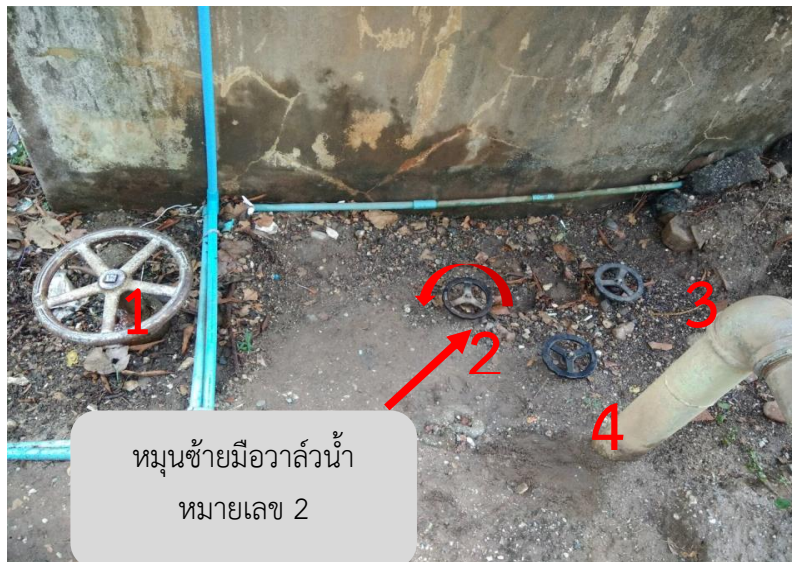
ภาพที่ 4.17 วิธีเปิดวาล์วหมายเลข 2 ตัวอย่างสีของน้ำทิ้งขณะที่ทำการล้างสารกรองน้ำ ดังภาพที่ 4.18
