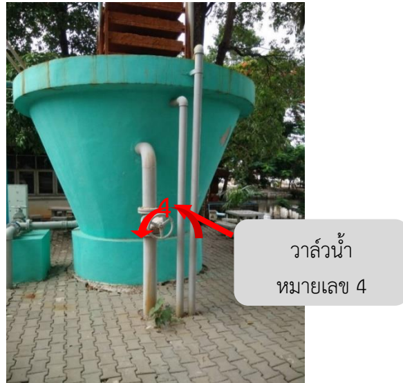
ภาพที่ 4.3 วิธีเปิดวาล์วระบายน้ำในถังกรองทั้ง
